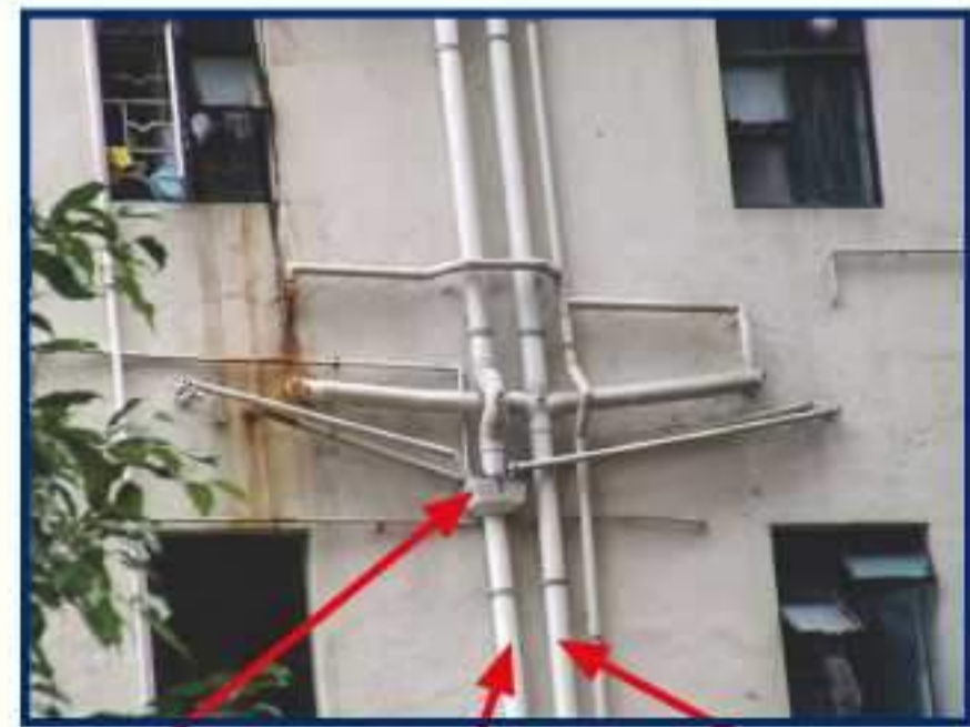
水斗 廢水喉管 糞喉管
